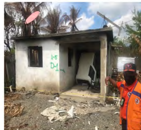
Foto No. 7 Vivienda Afectada
